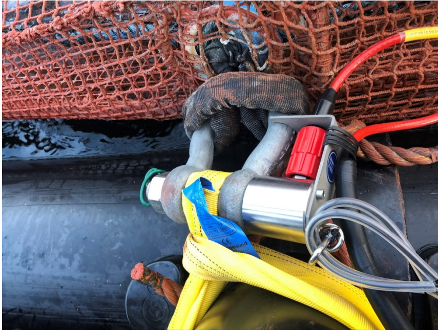
Figur 9 Lastsjakel montert på innfestingsløkke i tak
